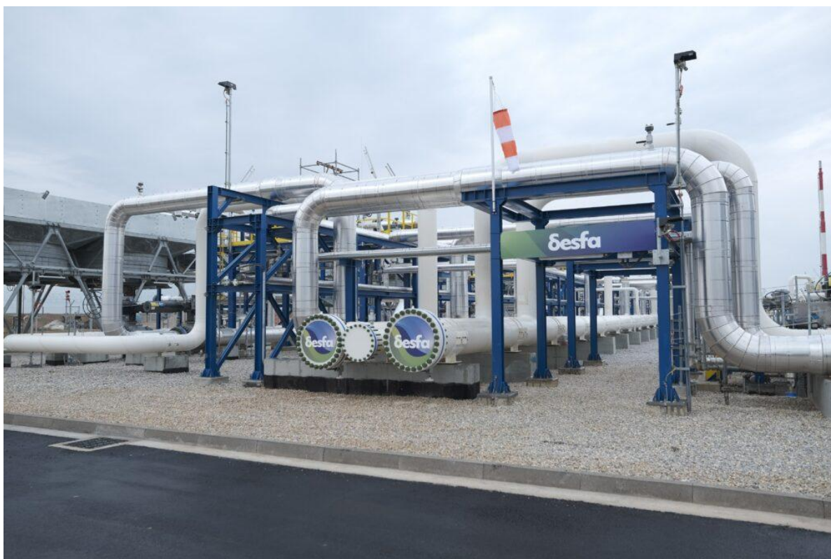
Σταθμός Συμπίεσης στην Κομοτηνή
